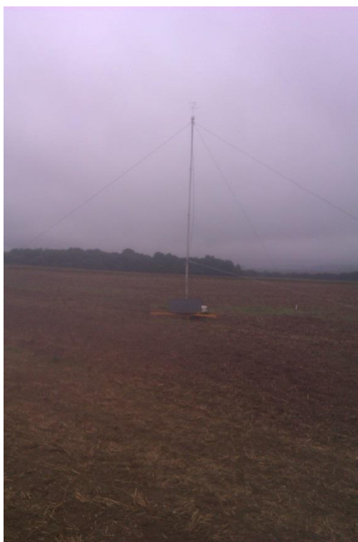
Installation de notre mât météorologique
